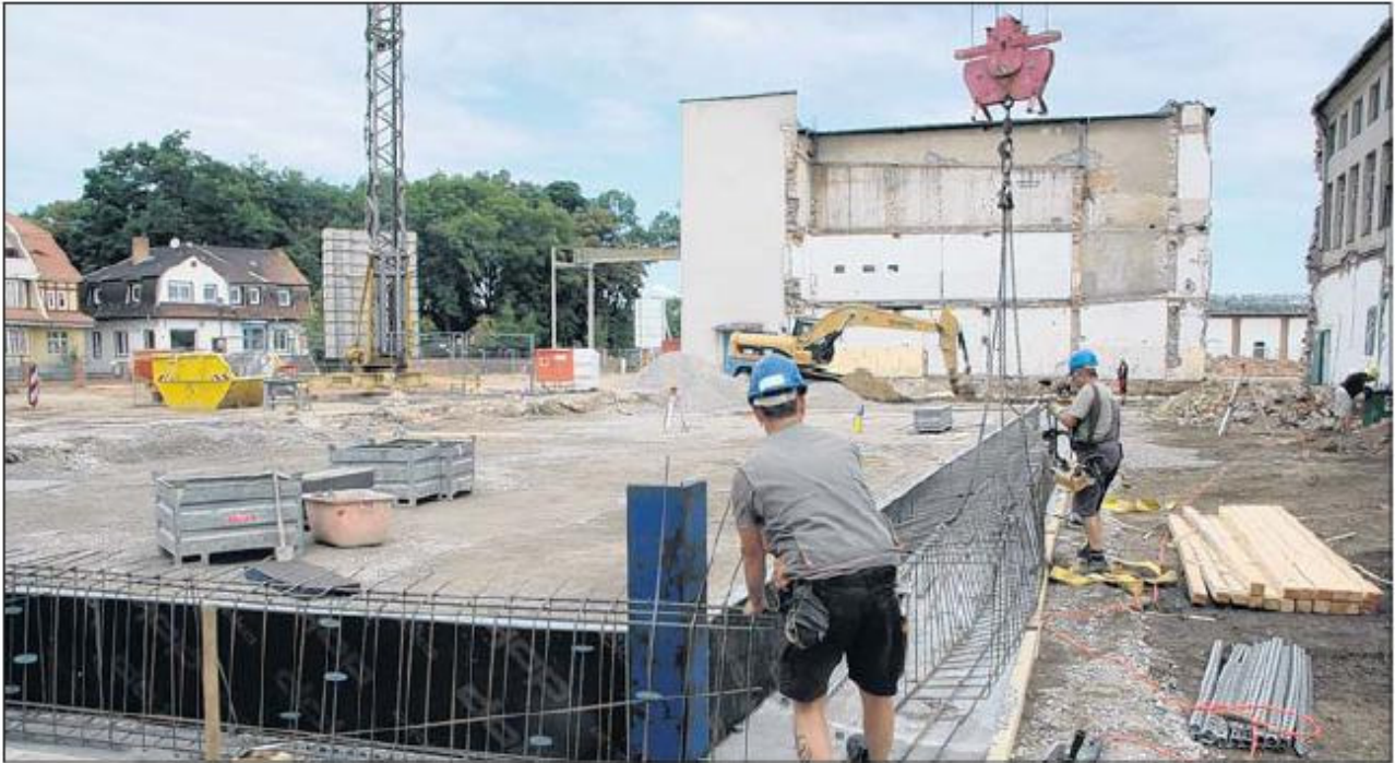
Donnerstag Vormittag wurde Bewehrung eingebracht, am Nachmittag sollte für die Bodenplatte des westlichen Flügels des neuen Ecole-Gymnasiums der erste Beton fließen... Foto: Klaus Dalichow
